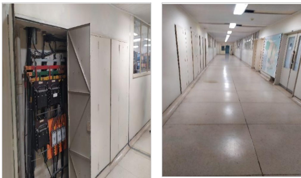
Figura A 3: QGBT com acesso a partes vivas das instalações – Circuitos elétricos sem identificação
