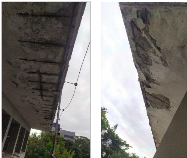
Figura A 2: Armadura exposta – Infiltração de água de chuva – Impermeabilização ineficiente da laje
