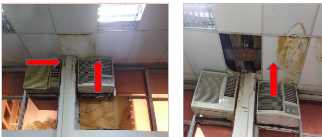
Figura A 1: Mancha de umidade – Infiltração de água de chuva – Impermeabilização ineficiente da laje de cobertura
