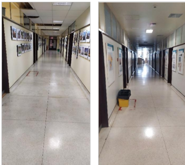
Figura A 8: Ausência de rota de fuga – Ausência de sistema de alarme e detecção de incêndio – Ausência de sistema de combate a incêndio
