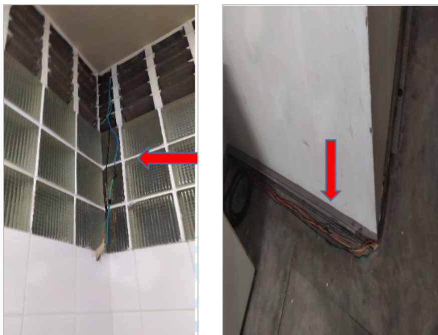
Figura A 5: Instalações elétricas inadequadas – Emendas inadequadas dos condutores – Cabos elétricos expostos
