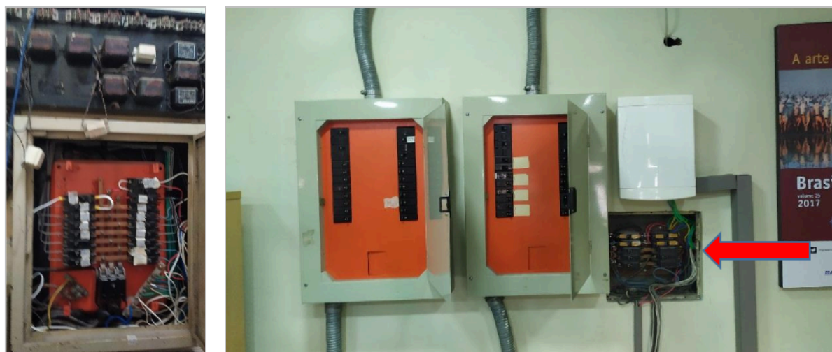
Figura A 4: Quadro de distribuição com acesso a partes vivas – Ausência de identificação dos circuitos elétricos – Ausência de condutor de proteção
