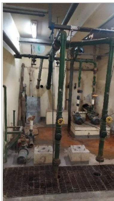
Figura A 11: Instalações hidrossanitárias inadequadas – Ausência de identificação das tubulações - Ausência de manutenção no sistema elevatório – Vazamento nas conexões
