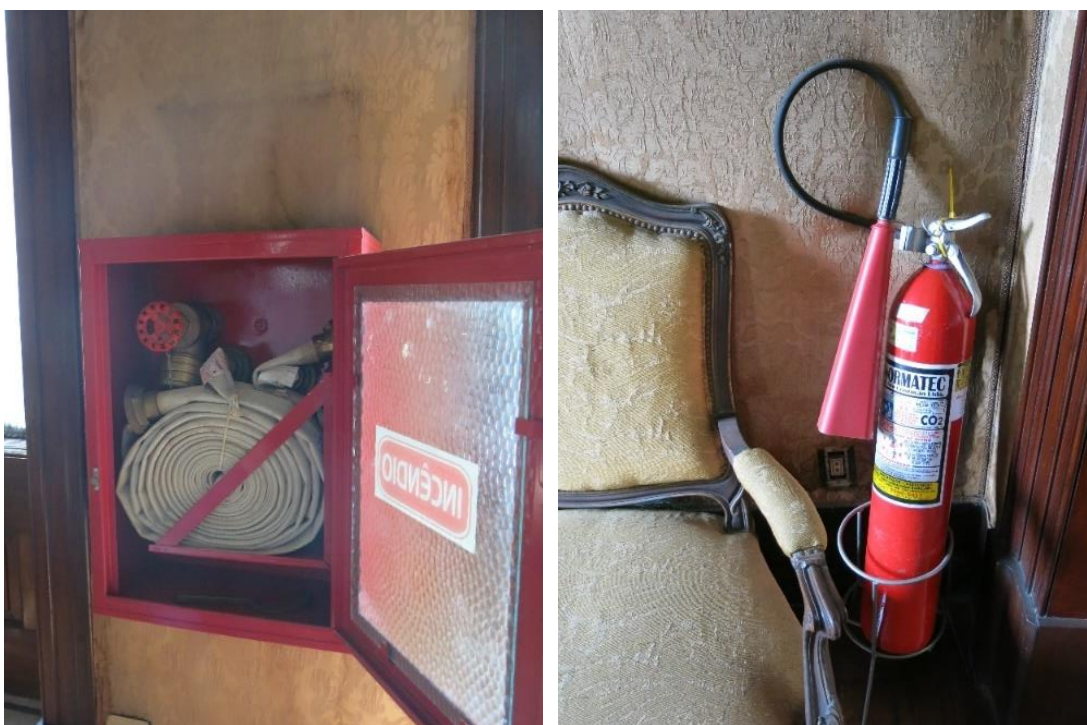
Figura 35 e 36: Hidrante interno e extintor de incêndio, respectivamente. Fonte: Instituto Pedra, set/2020.
