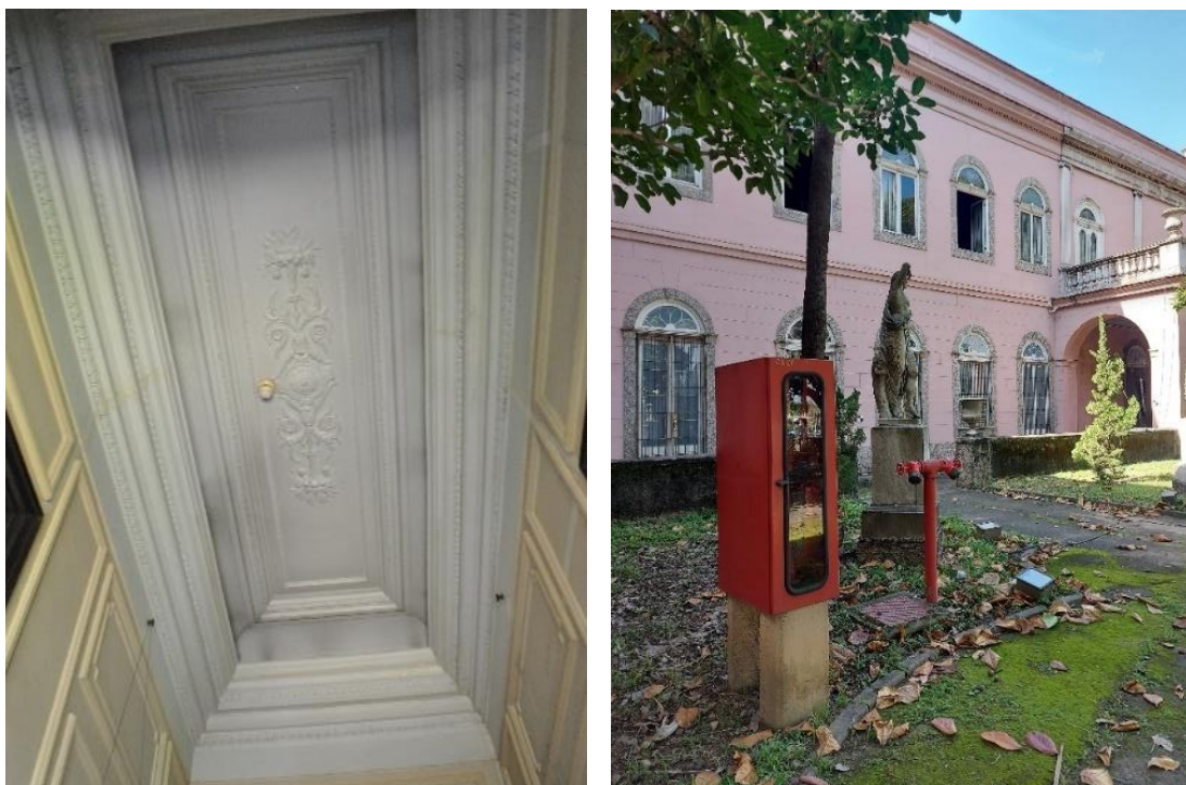
Figura 37 e 38: Detector de fumaça e hidrante externo. Fonte: Amanda Ribeiro Carneiro, set/2020 e jul/2022.
