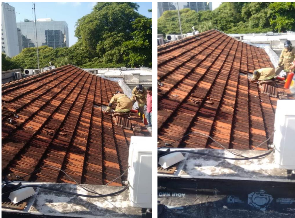
Figuras 33 e 34: Atuação do Corpo de Bombeiros no princípio de incêndio no ERERIO. Fonte: Escritório de Representação do Itamaraty no Rio de Janeiro – MRE, 03/03/2019.
